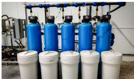
Ilustračný obrázok: inštalračia, technologickej časti zvlhčovacieho zariadenia a úpravňa vody
